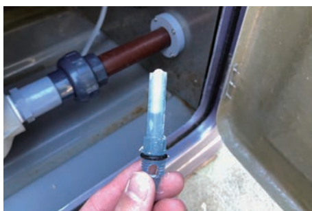
注入点の結晶化による詰まり
